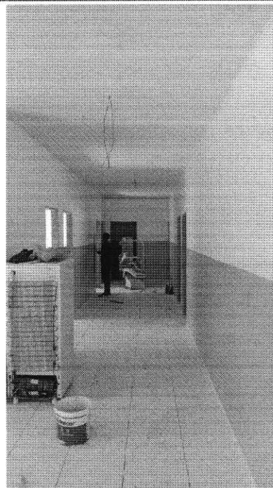
PASSAGEM DE CABOS - UBS GATO
