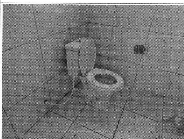
VASO SANITÁRIO/ ASSENTO SANITÁRIO - UBS CAMPO AGRÍCOLA
